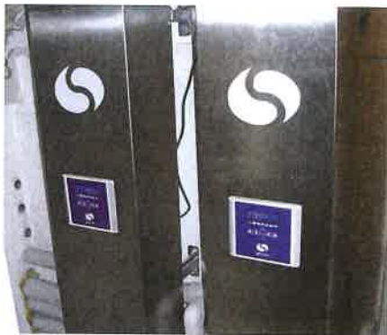
Zwei Seccua Virex Pro Legionellenfilter, installiert zum Schutz vor Legionellen in einem Gebäude mit 15 Nutzungseinheiten in München (Nymphenburg)
