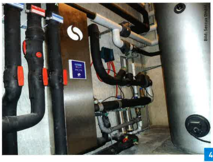
Seccua Filtration zum Schutz des Leitungsnetzes eines Kindergartens in München, eingebaut an der Übergabestelle des Kaltwassers vom Stadtnetz. Die Anlage verfügt über eine vollautomatische Prüfung der Rückhalteleistung für Mikroorganismen.
