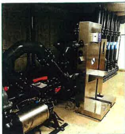
Abb.: Membran-Bioreaktor-Anlage von Seccua zur Abwasseraufbereitung in einem Shopping-Center in Mexiko City
