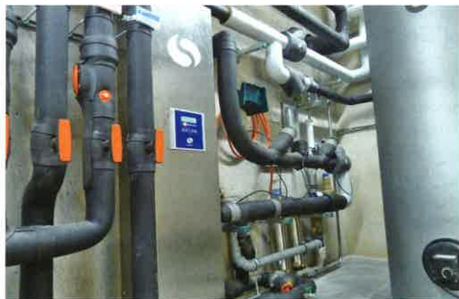
Membranfiltrationsanlage der Firma Seccua am Eintritt des Trinkwassers ins Gebäude
