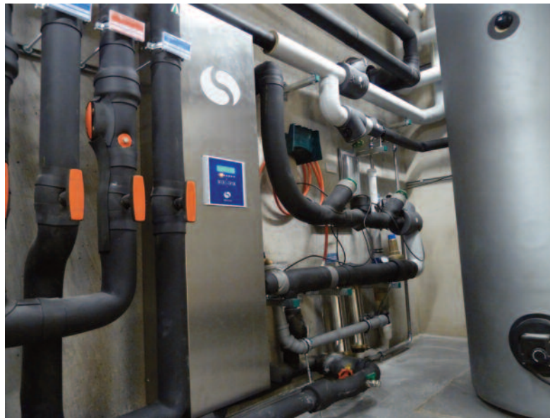
Filtrationsanlage im Kindergarten.
